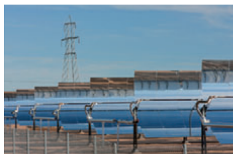
Parabolrinnenkraftwerke gehören zu den leistungsfähigsten und wirtschaftlichsten Konzepten unter den Solarthermiekraftwerken
